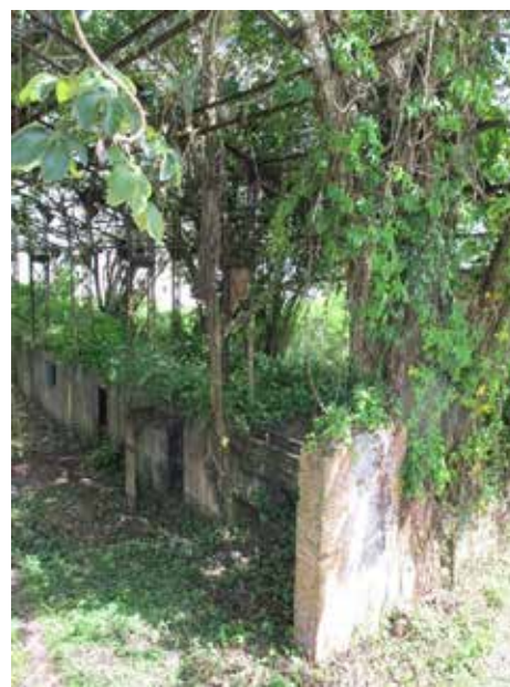
Figure 8: Forte présence de végétation sur les arases
